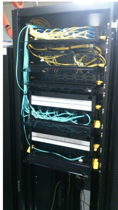
図6.新サーバ室内キャンパスネットワーク 光ファイバ収容ラック
