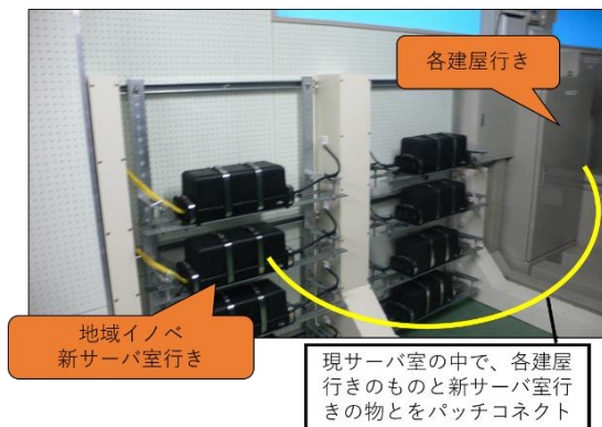
図5. 旧サーバ室内光ファイバ配線の様子
