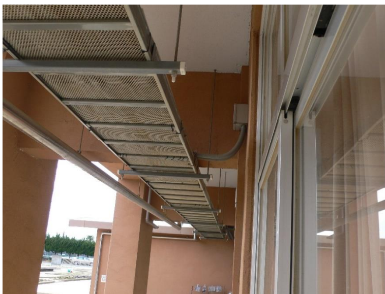
図 2. ベランダの軒下を通るケーブルラック
