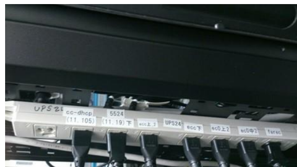
図8 移転で使用した電源タップのタグ
