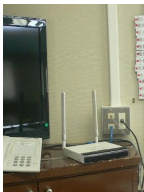
図 6 旧型リユースアクセスポイントの設置
